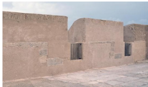
Fig. 10- Foto de parapeto del Baluarte Real con restos del parapeto original localizados bajo los revestimientos modernos (M a Josefa Balaguer, 2013)
