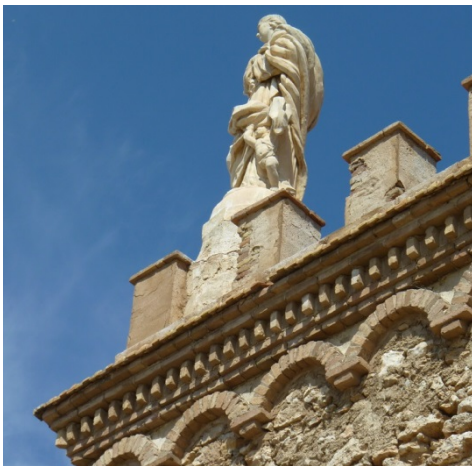
Fig. 3.- Imagen de la Virgen en la terraza de la Torre antes de la restauración. (P.E. Collado)
