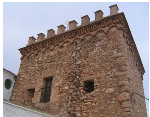
Fig. 4.- Detalle del estado de conservación de la Torre antes de la restauración. El actual balcón debió ser el acceso original. (P.E. Collado)
