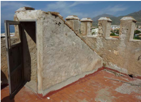
Fig. 5.- Detalle del estado de conservación del acceso a la cubierta antes de la restauración. (P.E. Collado)
