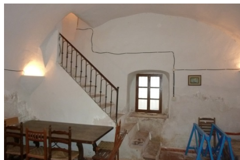
Fig. 6.- Planta baja interior de la Torre antes de la restauración. (P.E. Collado)
